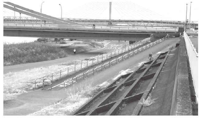
河川敷道路から葛西橋へ接続する坂路周辺が未耐震のまま
