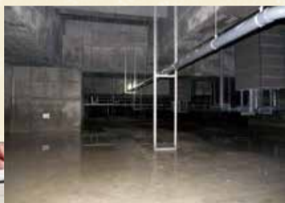
建物の下は盛り土せず空洞だった
